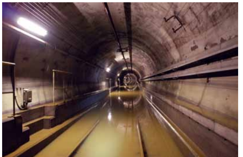
台風18号で浸水した御陵駅（京津線）
